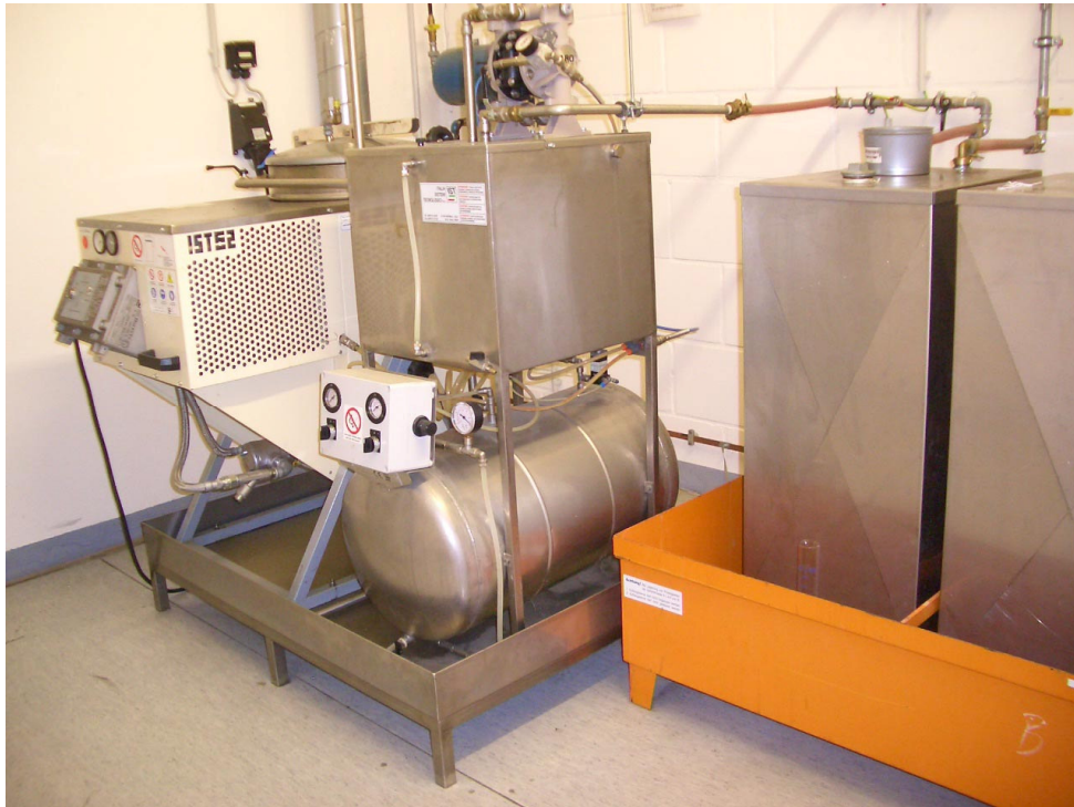
IST 62 with vacuum and tanks
